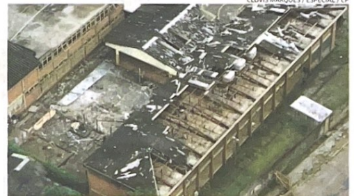
Prédio escolar, na Capital, está sem telhado desde janeiro deste ano
